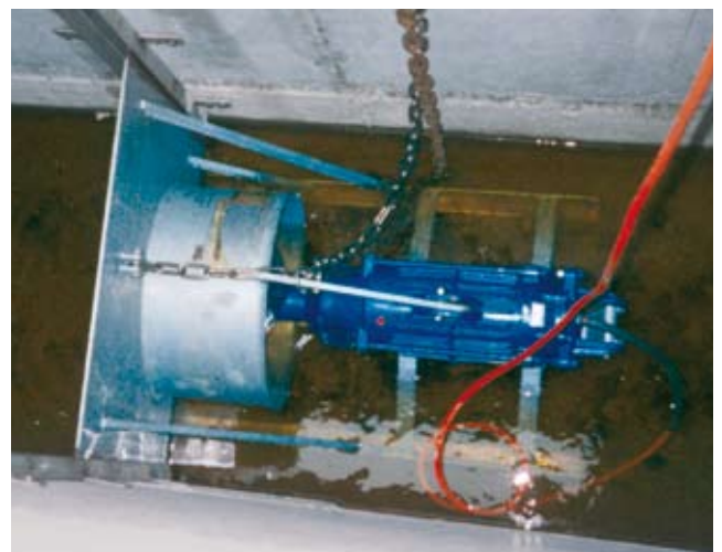
Tauchmotorrührwerk in Ringkanalsystem
