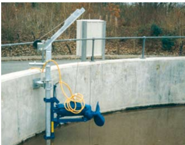
Tauchmotorrührwerk GTWSI 1040 im Schlammstapelbehälter einer Kläranlage
